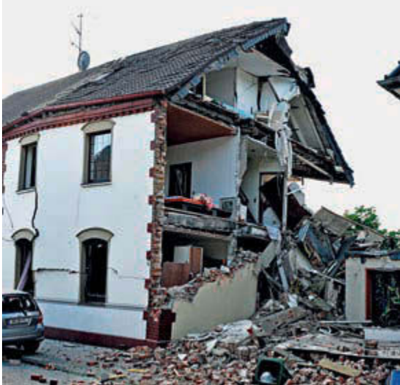
Verheerende Explosion an der Hirtenstraße: Ein Doppelhaus muss abgerissen werden
