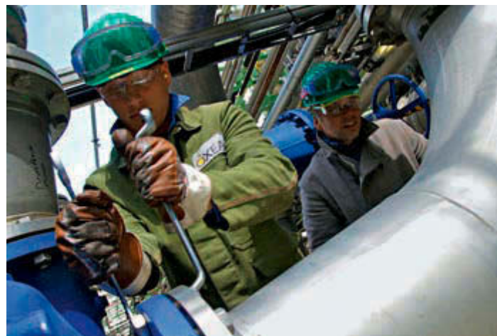
Die Sicherheit steht immer im Fokus: Produktionsmitarbeiter bei der Arbeit in einer Anlage
